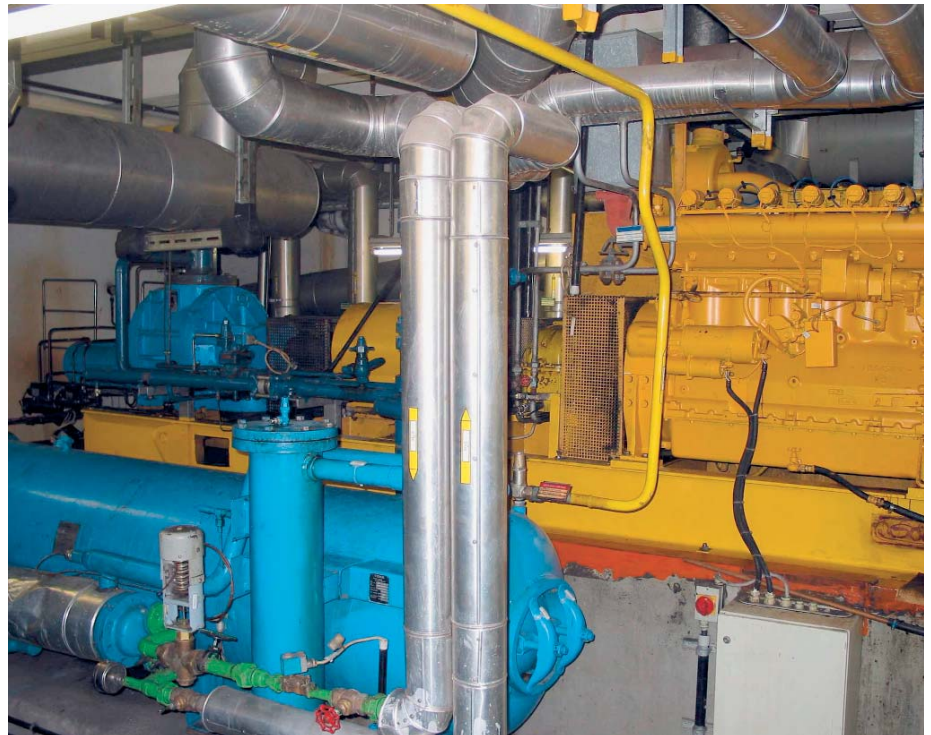
Die Kraftwärmekopplungsanlage der EFT – Energie Food Town. Der gelbe Gasmotor erzeugt 125 Kilowatt Wärmeenergie und 90 Kilowatt Antriebsleistung für die Kälteanlage. Foto: WLS
